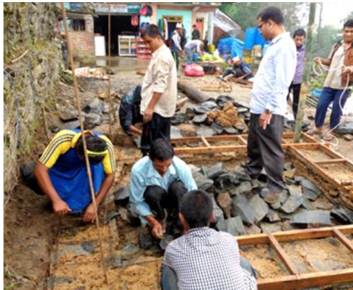
राडो नेपालले मकवानपुरको आग्रामा संचालन गरेको भूकम्प प्रतिरोधी घर निर्माण सत्रबन्धी तालिममा सहभागिहरू ।
